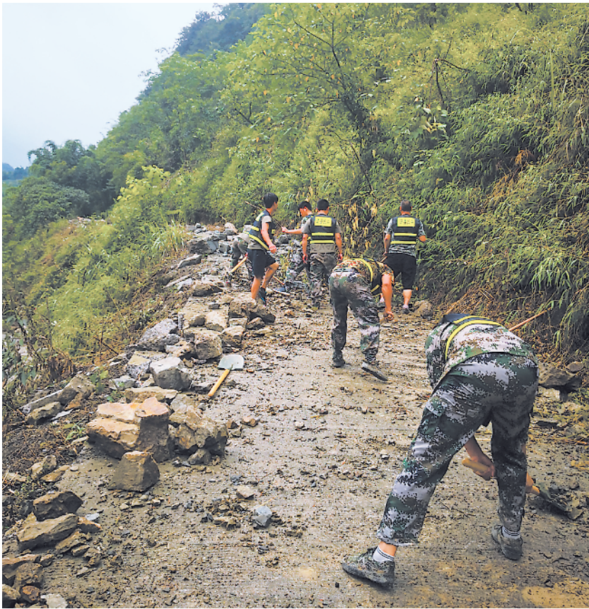
6月22日22点29分，四川省宜宾市珙县发生5.4级地震，珙县人武部领导第一时间率5个分队150名民兵，于23日20分到达震中珙县镇鱼池村，展开灾情排查及救援工作。图为23日上午，民兵清理疏通被山体滑坡阻断的道路。 马明水摄
