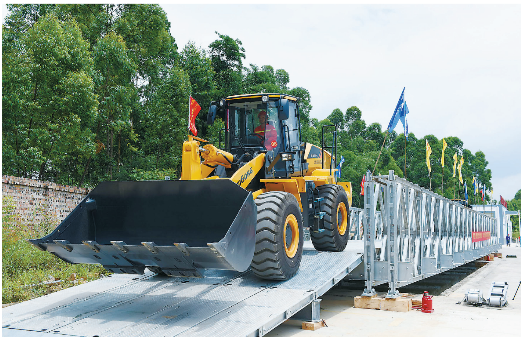
6月18日，广西人民防空和边防办公室组织开展战备钢桥架设演练。演练以洪水冲毁战备公路上的桥梁为背景，检验了交通战备分队紧急架设钢桥的能力。图为分队队员驾驶大型挖掘机通过新架设的钢桥，检测桥梁承重能力。朱映伊摄
