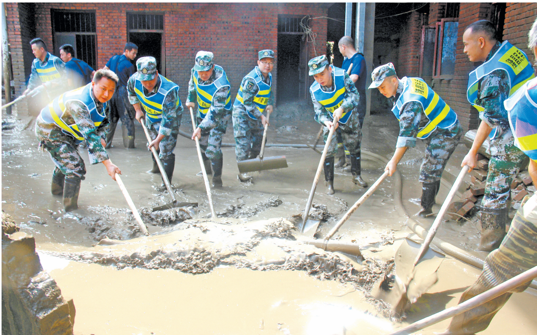
8月18日以来，沱江四省隆昌市桂花井段水位暴涨，当地不少村镇出现严重内涝。洪水消退后，隆昌市人武部出动干部、职工和民兵120余人，连续3天开展清理道路、清除淤泥以及消毒防疫等工作，帮助群众尽快恢复正常工作生活秩序。何驹摄
