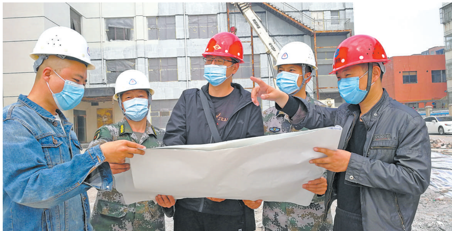
河南省焦作市着眼战斗力提升,开展拥军工作,热情帮助部队解决制约战斗力提升的瓶颈问题。图为四月十九日,该市军地相关人员,在市民兵训练基地建设现场指导施工进度。 辛振乾摄
