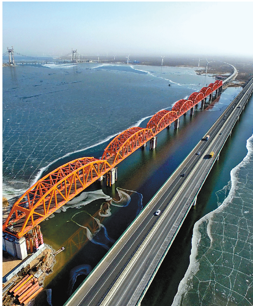
1月16日，京张高铁官厅水库特大桥拱型八孔钢桁梁最后一孔落梁成功，标志着该特大桥主桥主体结构全部施工完成，桥面附属工程将如期推进。据介绍，官厅水库特大桥全长9077米，是京（北京）张（张家口）高铁重要节点工程。新华社发
