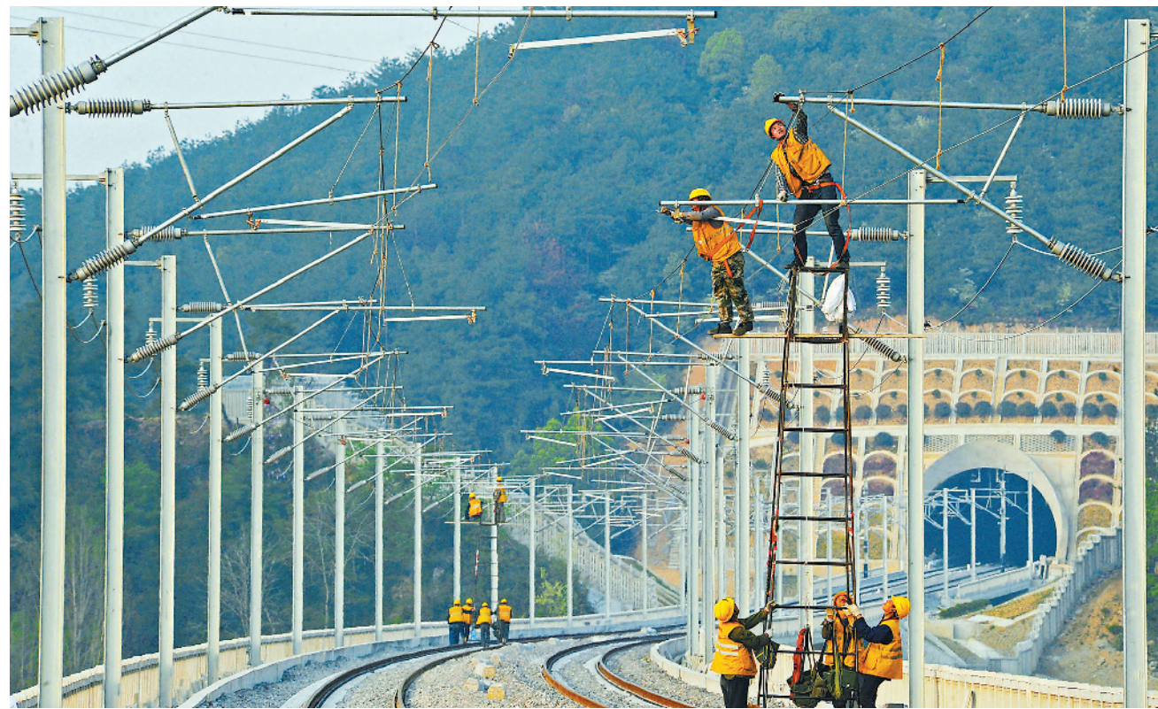
近日，杭黄高铁浙江段电气化施工进入冲刺阶段。杭（州）黄（山）高速铁路将与沪杭、杭甬、杭宁等高铁相连，进一步完善长三角城际铁路网。图为3月30日，施工人员在杭黄高铁浙江桐庐段调整接触网导线。新华社发
