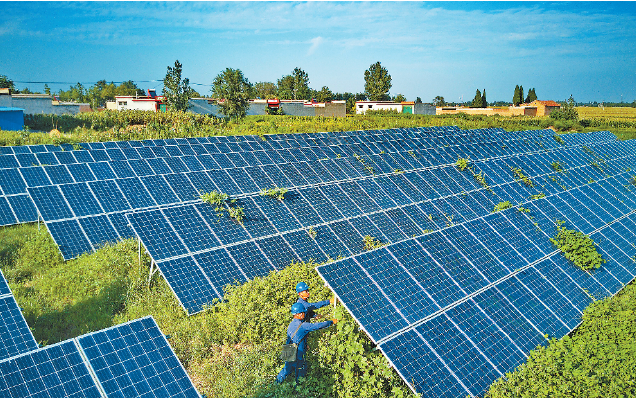
近年来,河北省石家庄、邢台、衡水、保定、邯郸和沧州等地区积极探索光伏扶贫——“阳光扶贫工程”,采取“全电上网”的模式将清洁电能全部并入电网。据河北南网公司介绍,截至目前,该公司辖区内光伏扶贫项目并网容量达223.4万千瓦,惠及10多万贫困人口。图为8月27日国网新河县供电公司工人在辖区望腾村扶贫光伏电站清理光伏板架上的杂草。
