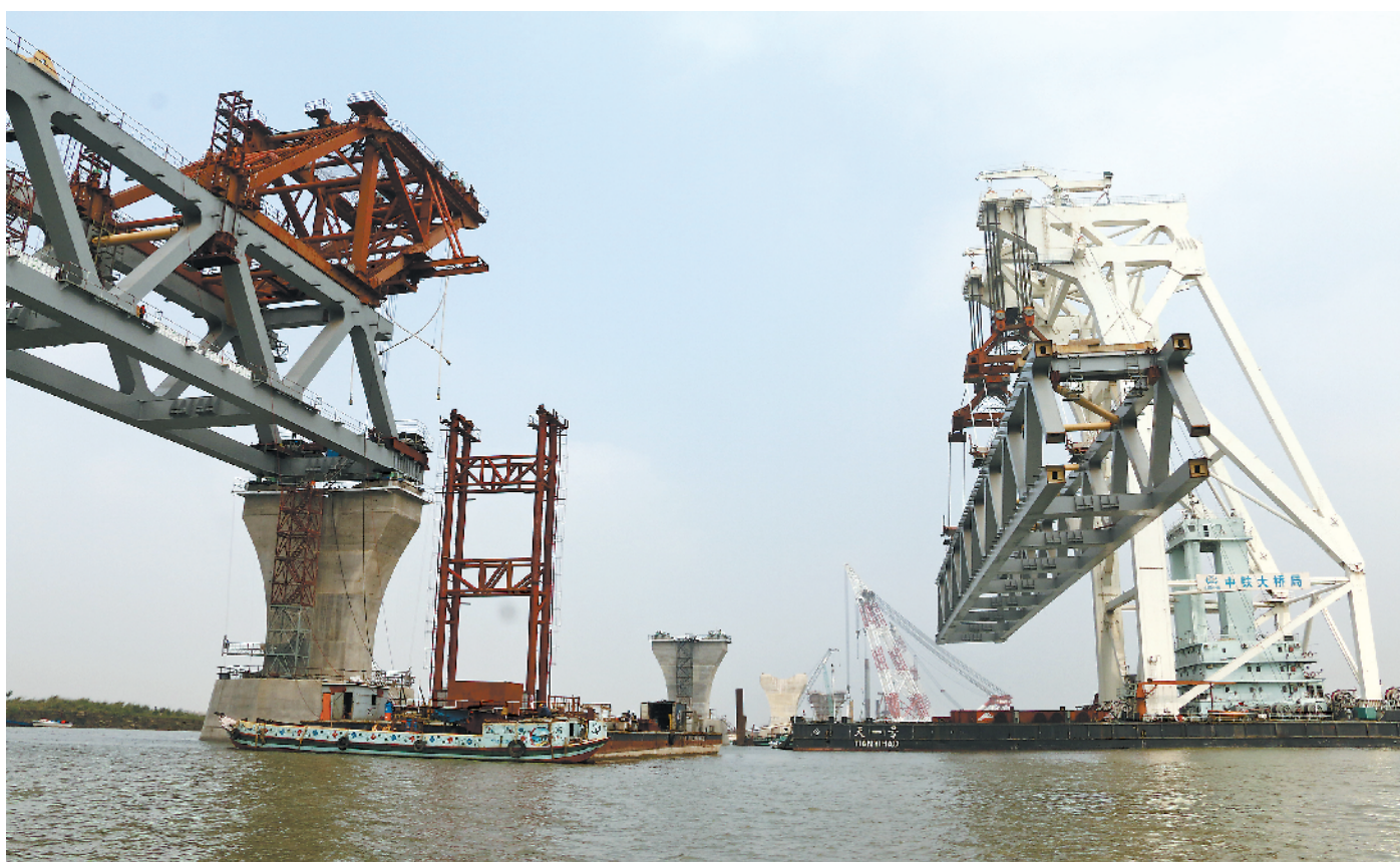
2月20日，在孟加拉国帕德玛河上，中国建造的万吨级中心架梁起重船“天一号”将总重超过3000吨的钢梁架放到桥墩上。
