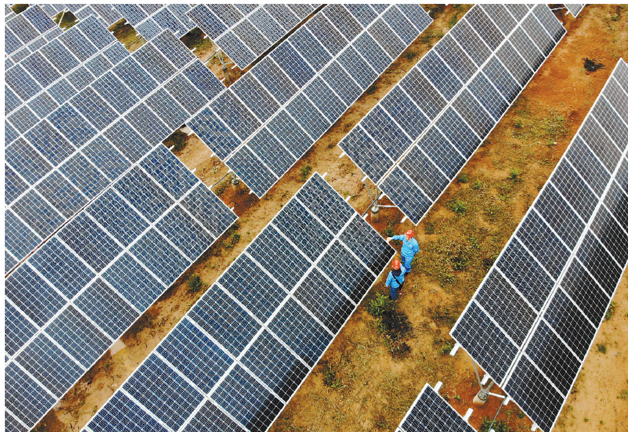
6月27日,随着装机容量为2.37万千瓦的青海省互助土族自治县村级光伏扶贫2号电站正式投产,国家下达给青海省的“十三五”第一批光伏扶贫项目全部实现并网发电。至此,青海全省1622个贫困村实现了光伏扶贫项目全覆盖。图为青海互助土族自治县村级光伏扶贫2号电站一角。 新华社发
