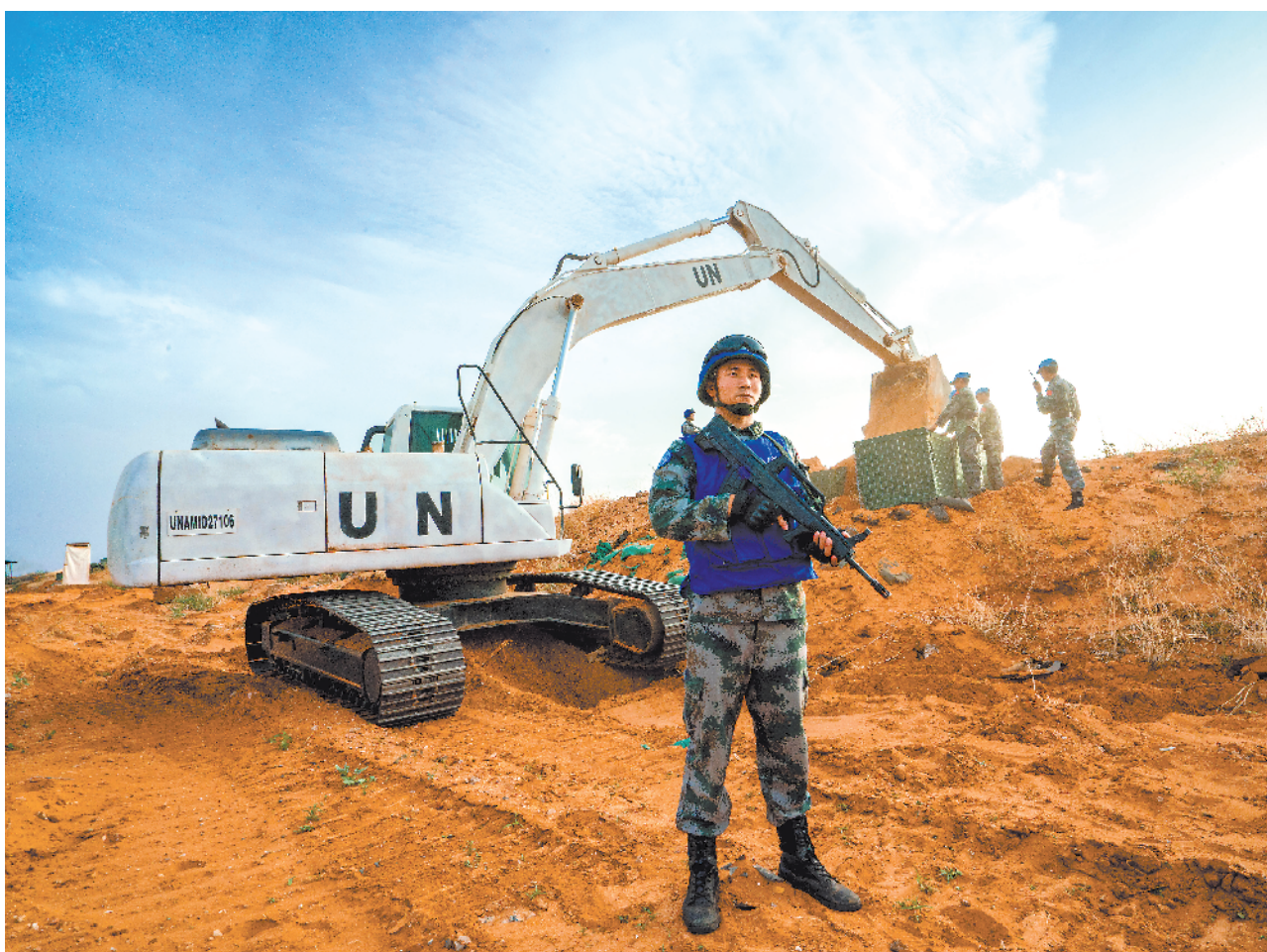
针对当地复杂敏感的安全局势,我第15批赴苏丹达尔富尔维和工兵分队连日来抓紧施工,高标准推进各超级营地及行动站点内防御工事的升级改造,以提升苏丹维和部队整体安全防护能力。图为分队官兵正在用沙箱堆置机枪火力点。
