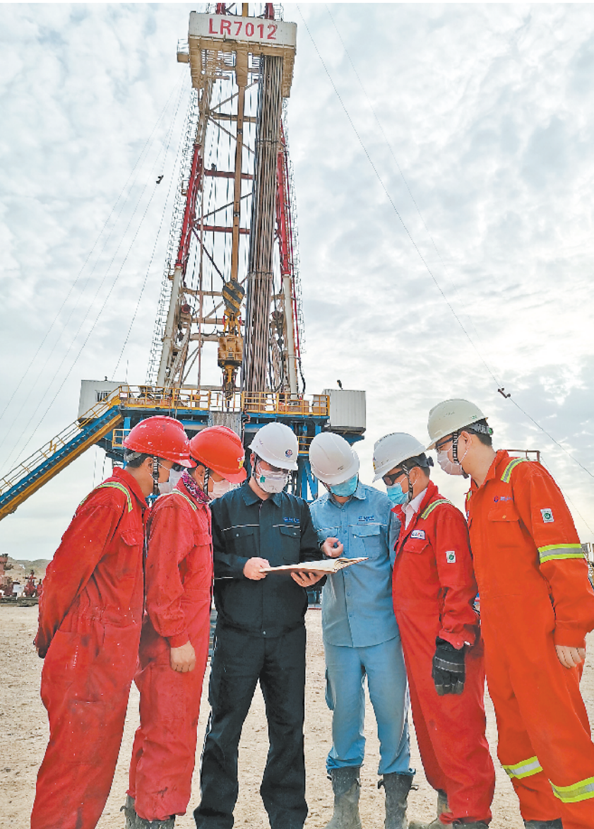
受新冠肺炎疫情影响，自2月初开始，在伊拉克的中资企业中员工工暂停休假轮换。面对陡增的压力，两个多月来，中资企业的上万名中方员工坚守岗位，并与伊方携手互助，共同抗疫。图为近日，在伊拉克米桑省米桑油田，中海石油工程有限公司员工在钻机作业现场工作。 新华社发
