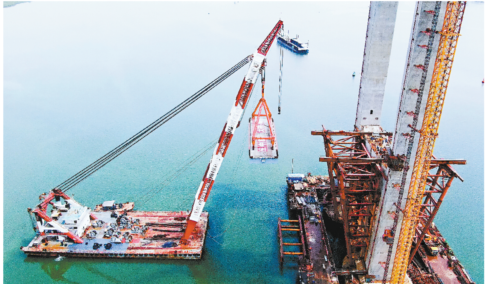
五月二十九日，广东湛江调顺跨海大桥首片主梁架设完成。据了解，大桥主梁采用扁平流线型全封闭钢箱组合梁，预计今年十一月完成全部架设任务。图：跨海大桥施工现场。
