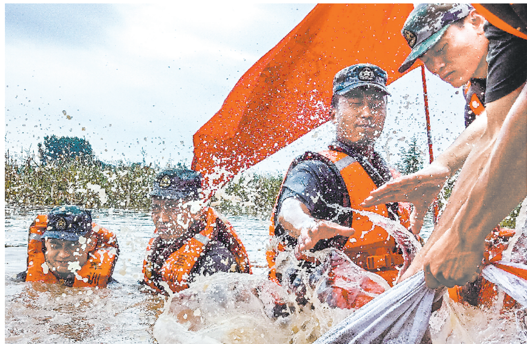
7月中旬,第71集团军某旅官兵奔赴抗洪一线后,迅速开展抢险救灾任务。图为封堵管涌。方知摄
