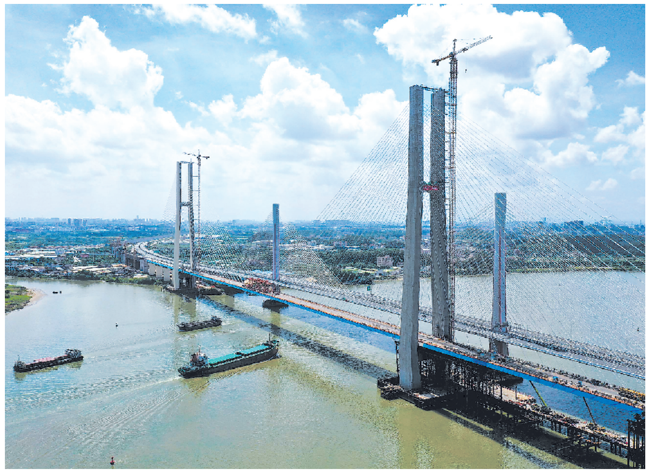
8月9日，粤港澳大湾区基础设施“硬联通”重点工程——广州南沙港铁路跨西江特大斜拉桥完成最后一块钢箱梁吊装作业，大桥即将合龙。该桥位于广东佛山市和江门市交界处，全长1117.5米。
