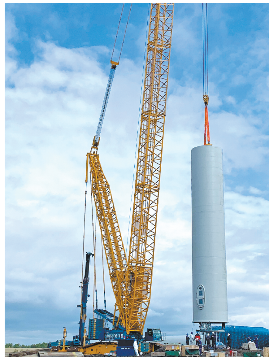
图为在哈萨克斯坦科斯塔奈州风电场施工现场，工作人员吊装中国生产的风机叶片。
