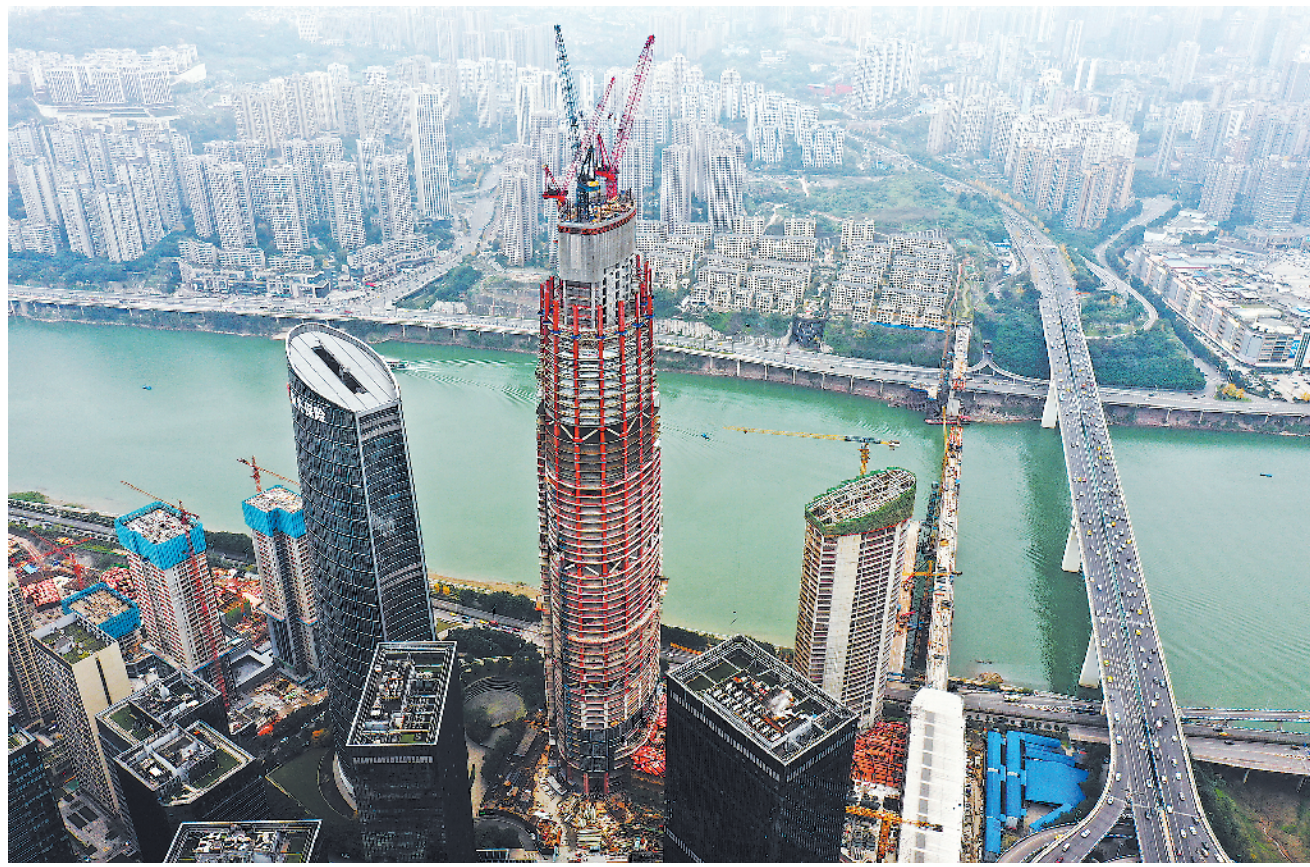
近日,重庆龙桥超高层二期三期项目458米主塔楼主体结构正式突破300米。重庆龙桥超高层二期三期工程位于重庆市中区化龙桥片区,是集商业、办公于一体的超大型综合性建筑群。
