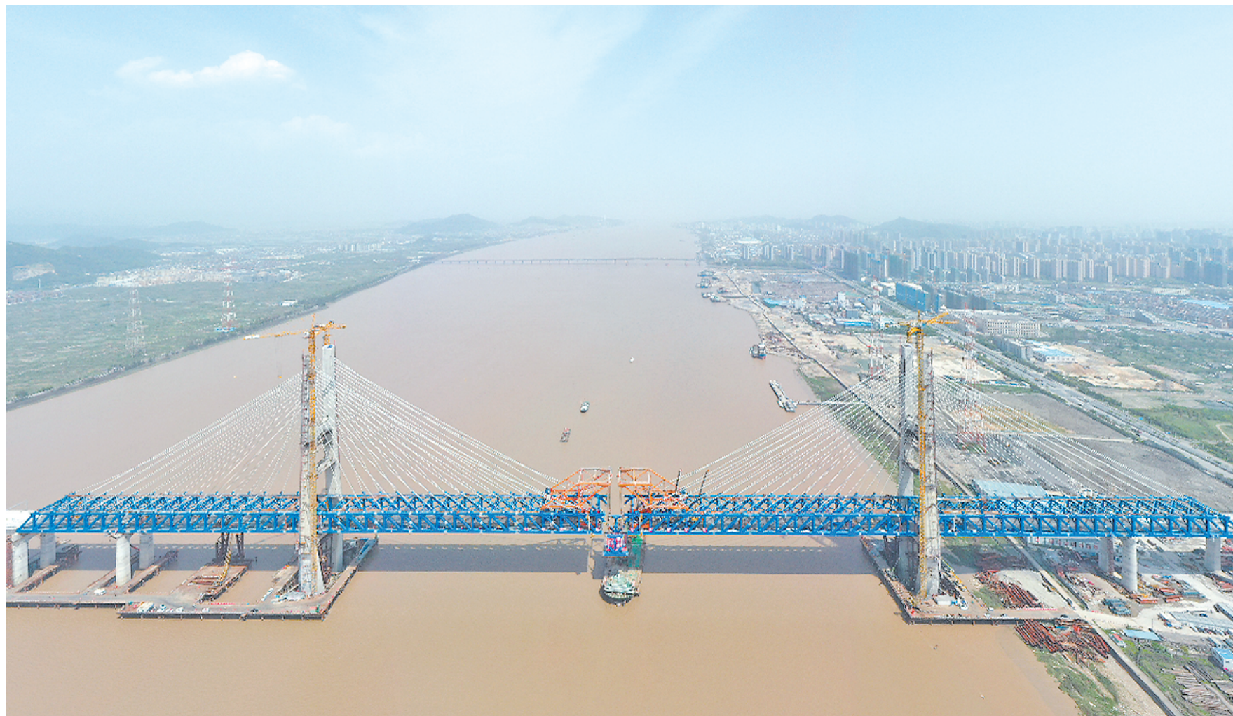
4月17日，随着最后一块钢梁吊装完成，杭绍台铁路控制性工程椒江特大桥顺利合龙。杭绍台铁路是我国首条民营资本控股的高速铁路项目。该线路连接浙江杭州、绍兴和台州三地，线路设计时速350公里。 新华社发
