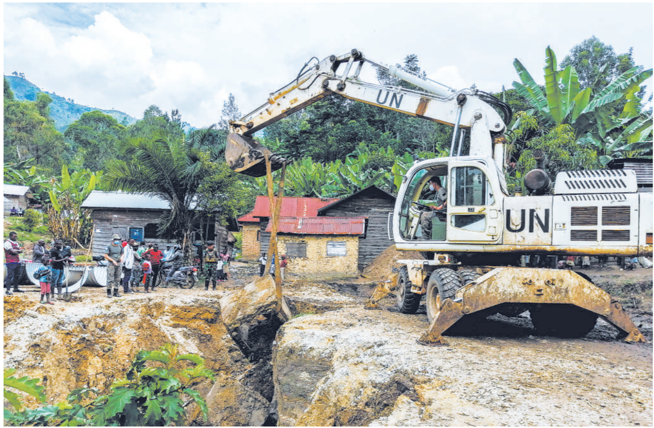
近日,中国第24批赴刚果(金)维和工兵分队根据联刚稳定团的命令,对刚果(金)东部地区主干道N2路布勒拉塌陷道路进行抢修。我维和官兵克服安全形势复杂、施工作业难度大等困难,历时13天,成功修复损毁道路,受到联刚稳定团民事部门及当地民众高度评价。图为我维和官兵操作挖掘机进行吊装拆除作业。席海春摄
