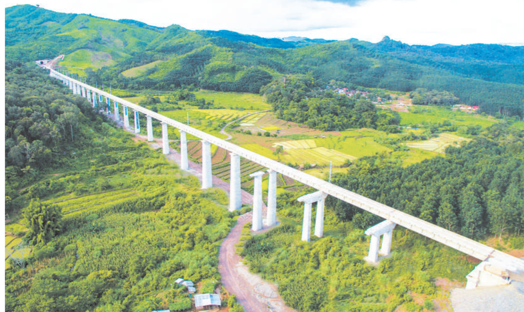
10月12日，中老铁路全线铺轨完成。这条千余公里的钢铁巨龙，从昆明出发，穿越磨盘山、哀牢山、无量山，跨过元江、阿墨江、把边江、澜沧江，经过中老铁路友谊隧道进入老挝，最终抵达万象。图为建设中的中老铁路。
