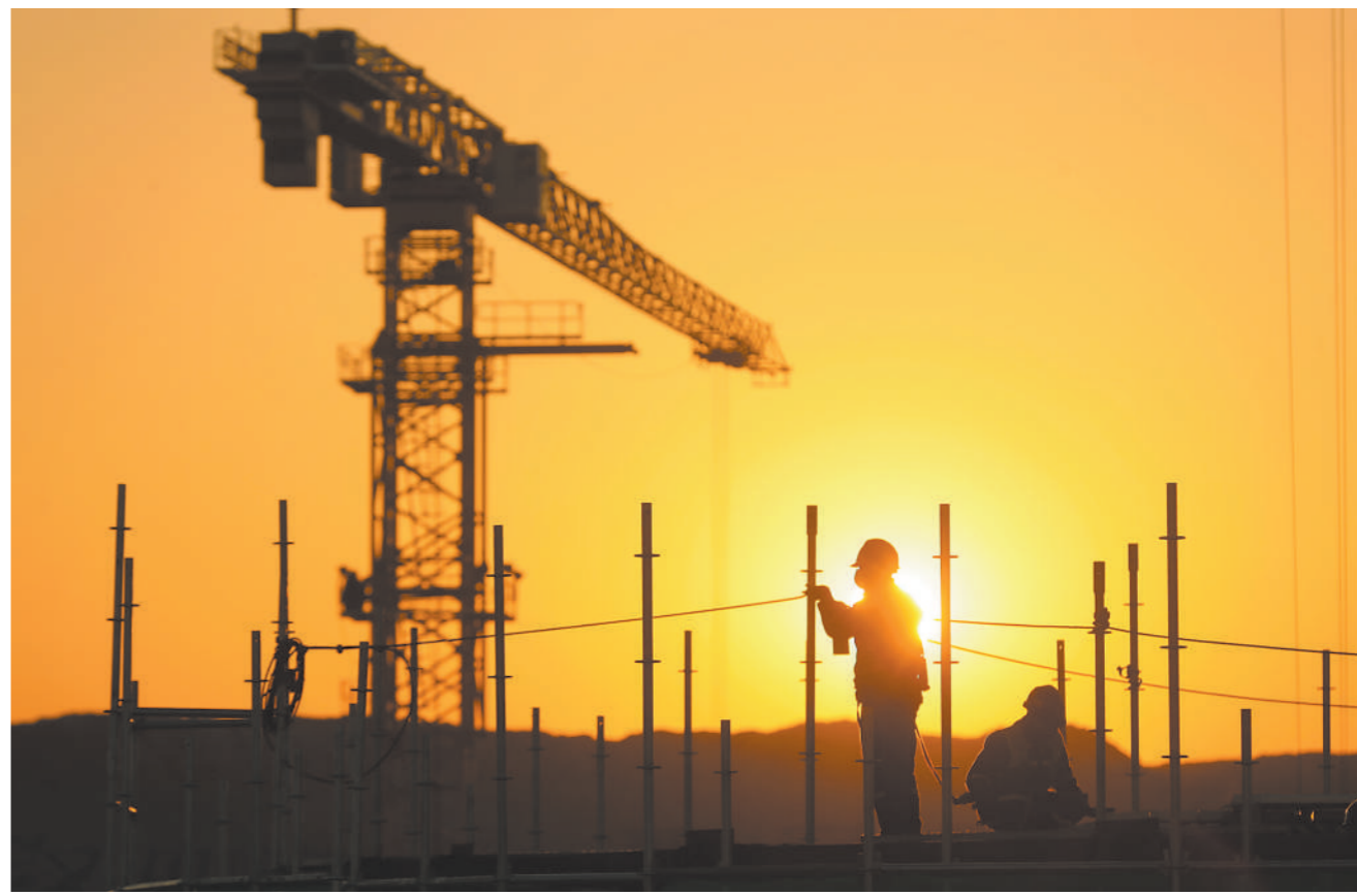
11月29日,“帕兰道夫斯基”号货轮驶入辽宁葫芦岛港,随着沈阳海关对其运载的从俄罗斯进口核电设备完成现场监管,中俄核能合作项目——徐大堡核电首批俄供大件设备顺利通关。徐大堡核电站是中国东北第二个,也是迄今中国最北的核电站。3、4号机组采用俄罗斯VVER-1200机型,单机容量127.4万千瓦。图为工人在徐大堡核电站3号机组施工现场作业。新华社发
