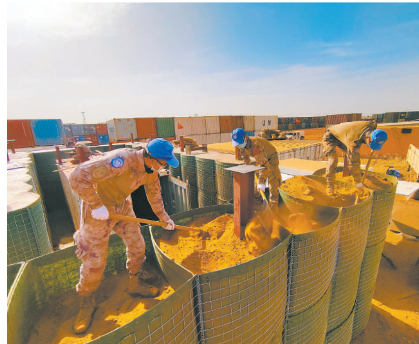
近日,我第9批赴马里维和工兵分队高标准完成帮助维和友军修建弹药库任务。分队制订详细施工方案,经过16个工作日的紧张作业,提前两周完成任务。图为维和官兵在施工中。 王宏阳摄
