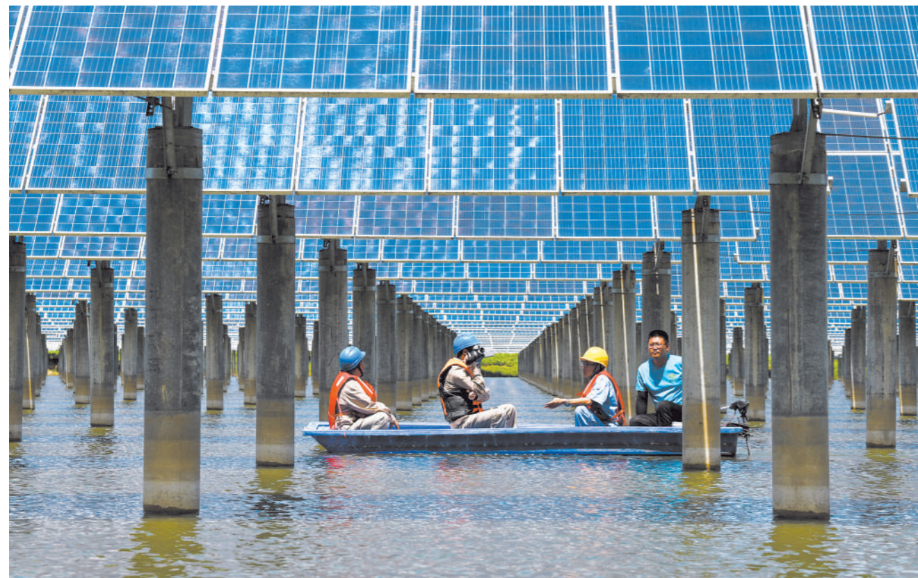
7月18日,在天津市宁河区宁河镇大月河村,国网天津电力宁河公司运维检修人员在110千伏大月河光伏电站进行年中检修巡查。该光伏电站总装机容量80兆瓦,建设在约3000亩的鱼塘上,让鱼塘形成了“水上发电、水下养鱼”的绿色生态养殖模式,极大提高单位面积土地的经济价值。每年还以土地流转的方式让村民增收,进一步助力乡村振兴。新华社记者 孙凡越摄
