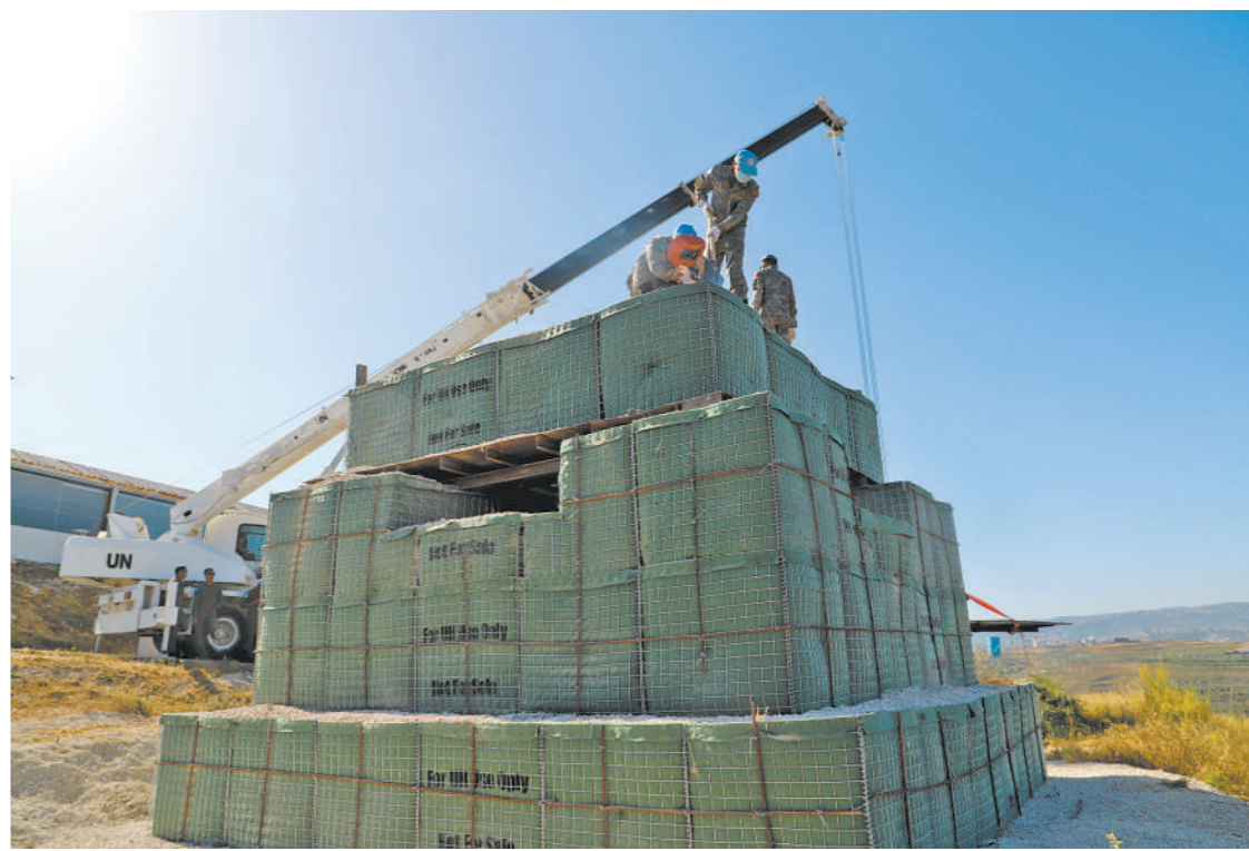
近日，经过近一个月的连续奋战，中国第20批赴黎巴嫩维和多功能工兵分队，高标准完成联合国部队马米西亚维和分队营区防务观察哨修建任务，受到维和友军的高度评价。
