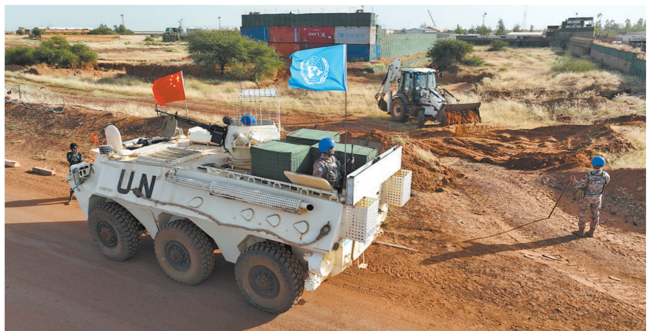
近日,中国第10批赴马里维和工兵分队圆满完成联合国加奥超管外国防御设施修复任务,有效提升了营地应对安全风险能力。图为施工现场。 葛学禹摄
