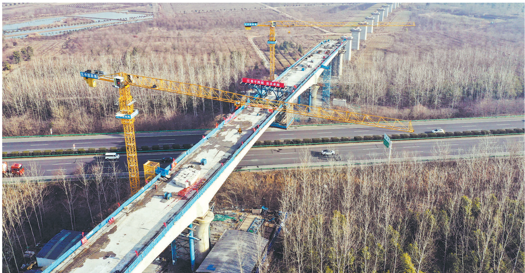
1月7日，中铁四局合新铁路安徽段跨沪陕高速连续梁顺利合龙。合新铁路起自安徽合肥，终至江苏新沂，设计时速350公里。 新华社发
