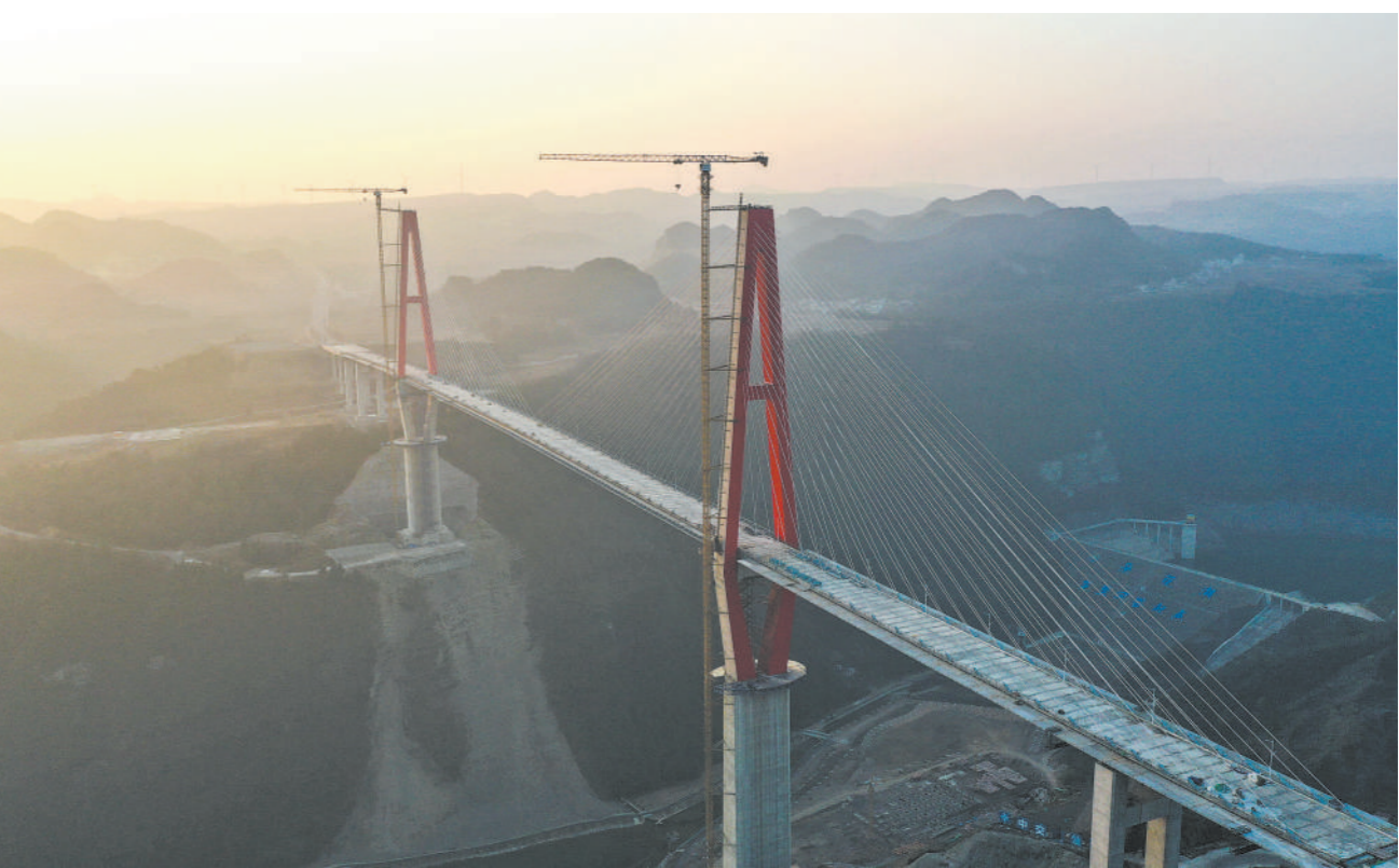
新春时节，贵州省龙里县天气晴好，建设中的龙里河大桥沐浴在晨光中，雄浑壮观。
