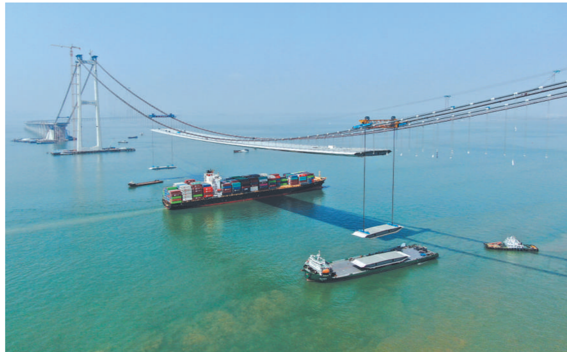
2月22日，集装箱货轮通过正在吊装钢梁的深中通道伶仃洋大桥。新华社记者 邓华摄
