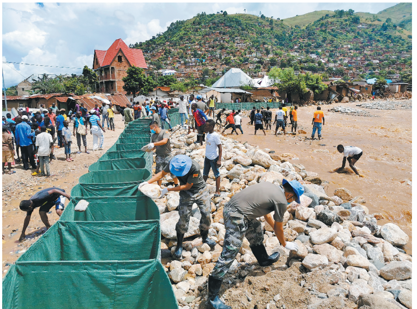
连日来，刚果（金）东南部基伍省地区暴雨不断，多地暴发山洪和泥石流灾害。4月20日，中国第23批赴刚果（金）维和工兵分队乌维拉分队，受联合国刚果（金）稳定特派团请求，协助当地紧急修筑姆隆维河防洪堤工程。图为官兵利用填石铁笼修筑防洪堤。李文炯摄
